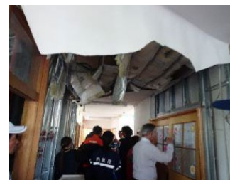
壁紙等が落下した天井部分
