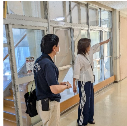
建物の亀裂(くまむた荘)
